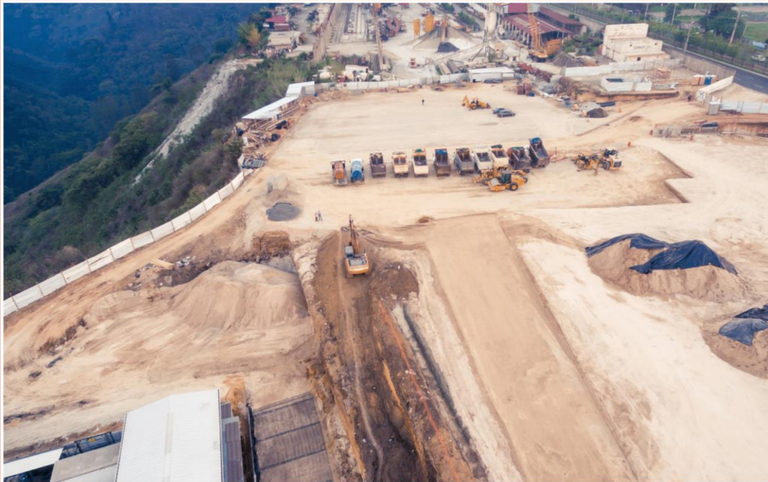
Fase de movimiento de tierra e instalación de geomalla TenCate Mirafi 7XT y 10X
