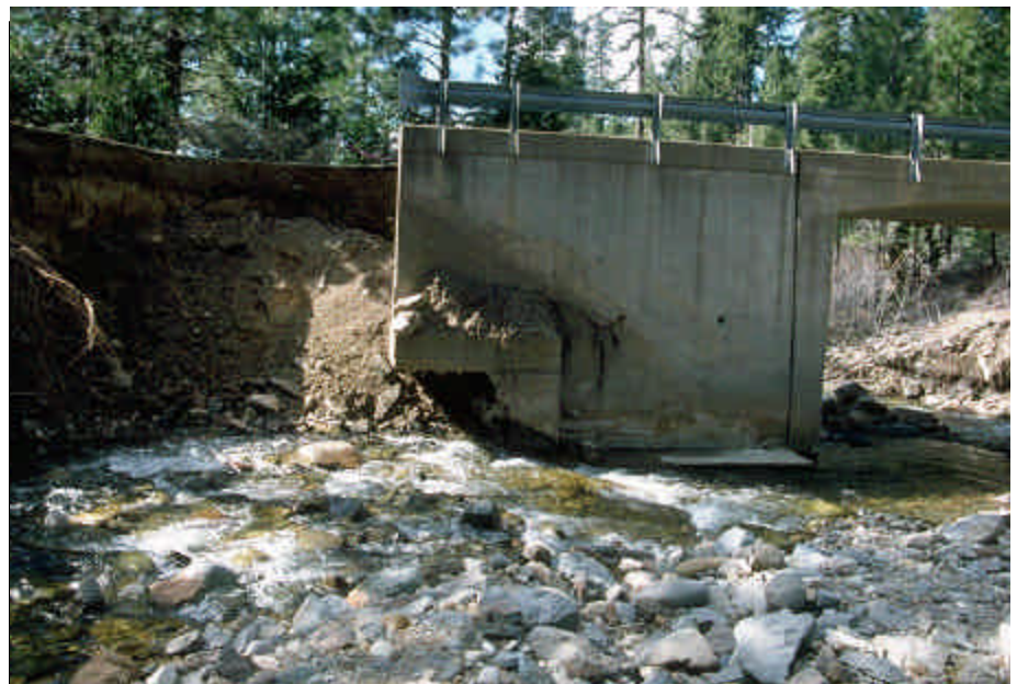
Foto 10.3 La socavación es una de las causas más comunes de falla de puentes. Use un claro lo suficientemente ancho para minimizar la constricción del canal natural. Ubique la cimentación del puente sobre roca sana siempre que sea posible, o por debajo de la profundidad de socavación, y recurra a medidas de protección de las márgenes, tales como enrocamiento, a fin de evitar la socavación.
