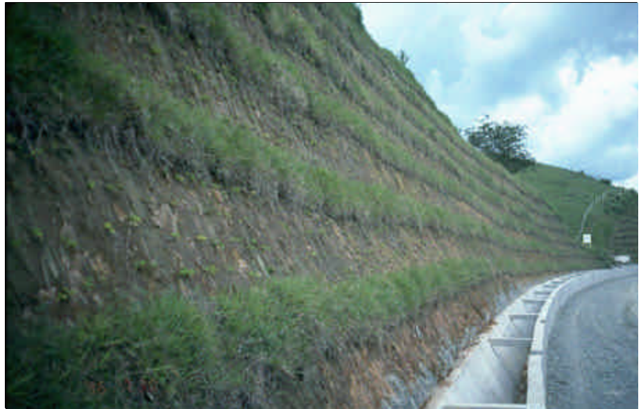
Foto 13.10 Uso de pastos, plantados en hileras, para proporcionar estabilidad a la superficie del talud y control de la erosión en cortes escarpados del camino.
