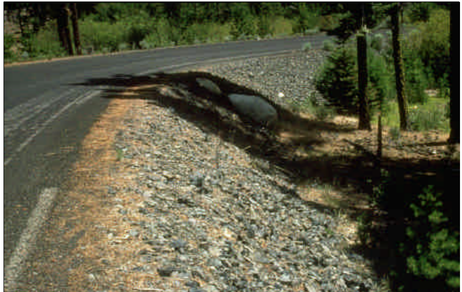
Foto 13.7 Protección de enrocamiento, colocada sobre el talud de un relleno de suelo erosionable adyacente a un arroyo, que se usa para un control durable y permanente contra la erosión.
