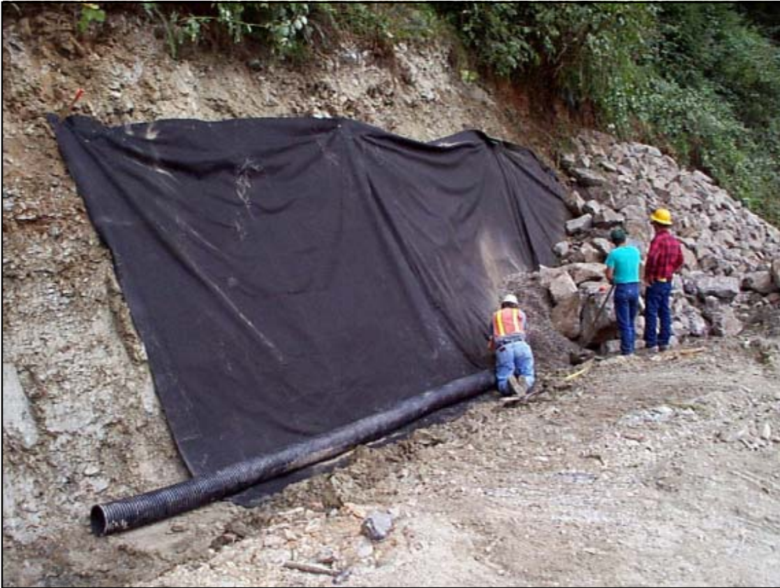
Foto 6.5 Tela de filtro (geotextil) como respaldo de un contrafuerte de talud, hecho con roca suelta que se usa para proporcionar filtración, permitir la infiltración y evitar el desplazamiento del suelo fino hacia la roca (Foto de Richard Van Dyke).
