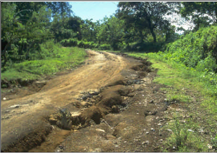
Foto 1.2 Camino con drenaje inadecuado que tiene una superficie de rodamiento rugosa para los usuarios, en una fuente de contaminación por sedimentos, y resulta relativamente cara para darle mantenimiento.
