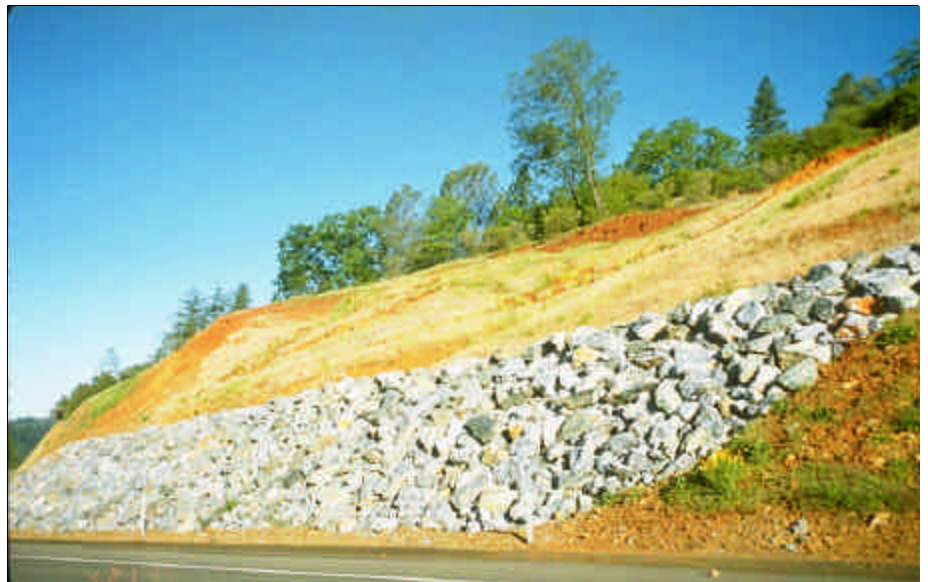
Foto 11.7 Se puede usar ocasionalmente un contrafuerte de roca permeable para estabilizar una zona de falla de talud en un corte.
