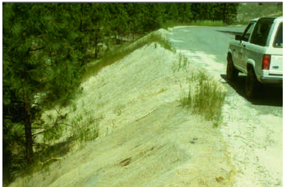
Foto 13.3 Cubra los taludes de terraplenes, sitios de trabajo y otras áreas expuestas del suelo con paja, redes roca u otro tipo de materiales, a fin de proteger el terreno y promover el crecimiento de la vegetación.
