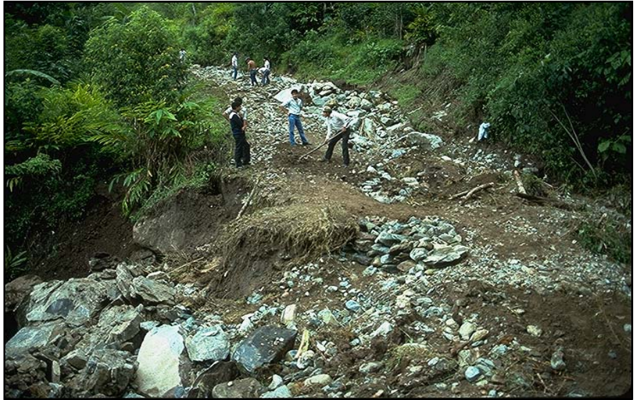
Foto 3.4 Camino que ha sufrido grandes daños durante una tormenta, debido al tamaño insuficiente del tubo de alcantarilla, que se tapó y a la falta de protección contra desbordamiento.
