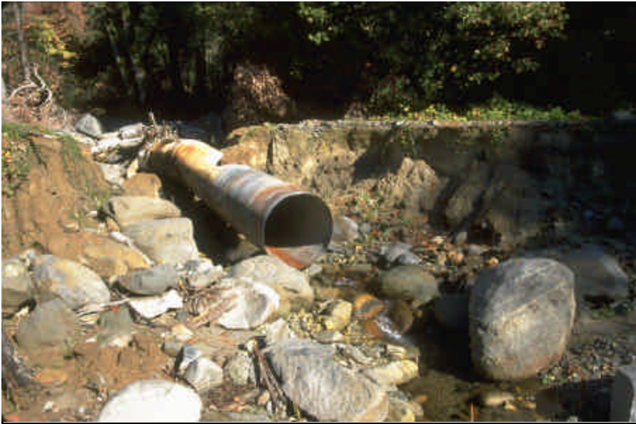
Foto 8.2 Falla de una alcantarilla debido a la capacidad de flujo insuficiente o tamaño inadecuado del tubo para dejar pasar escombros (boleos) encontrados en el drenaje.
