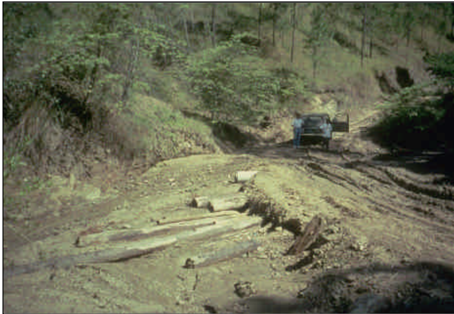
Foto 8.10 La mayoría de las alcantarillas de troncos tienen una capacidad de flujo muy limitada. Retire las alcantarillas provisionales de troncos (Tipo Humbolt) antes de tormentas fuertes o de la temporada de lluvias.
