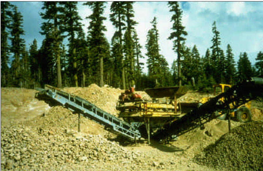
Foto 12.10 Las pedreras y bancos de préstamo pueden proporcionar un recurso excelente y relativamente barato como fuente de materiales para el proyecto. Un sitio de explotación puede sólo necesitar una excavación simple, cribado o triturado, para producir los materiales necesarios. Controle el uso de la zona con un Plan de Desarrollo de Bancos.
