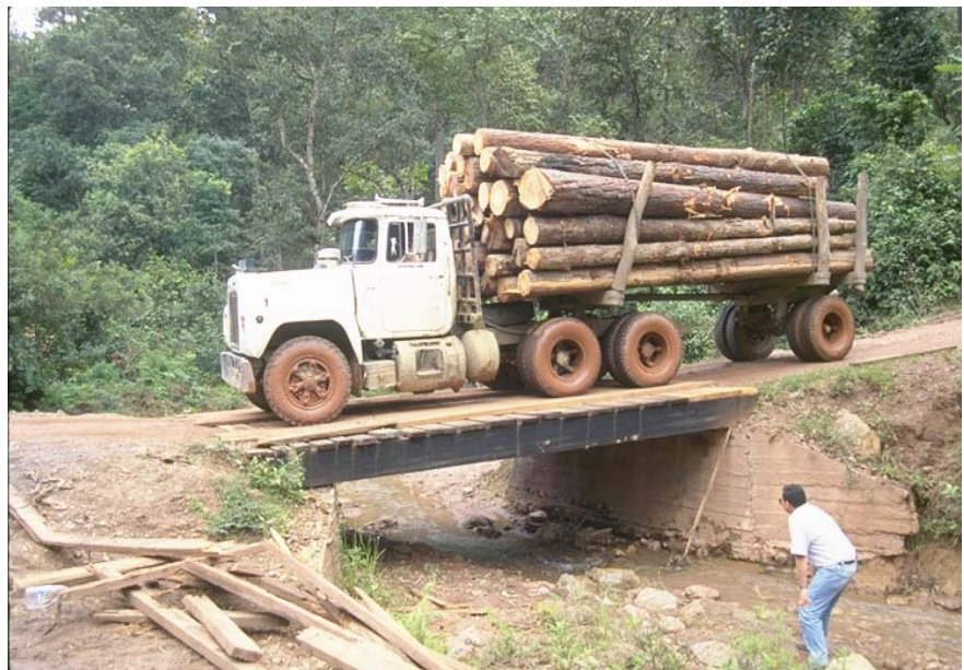
Foto 10.1 Se pueden usar alcantarillas, vados o puentes para el cruce de arroyos. Use puentes para atravesar arroyos permanentes anchos, para minimizar las alteraciones al cauce y evitar retrasos en el tránsito. Use un claro lo suficientemente ancho como para evitar la constricción del canal natural. Ubique la cimentación sobre roca sana o por debajo de la profundidad de socavación.
