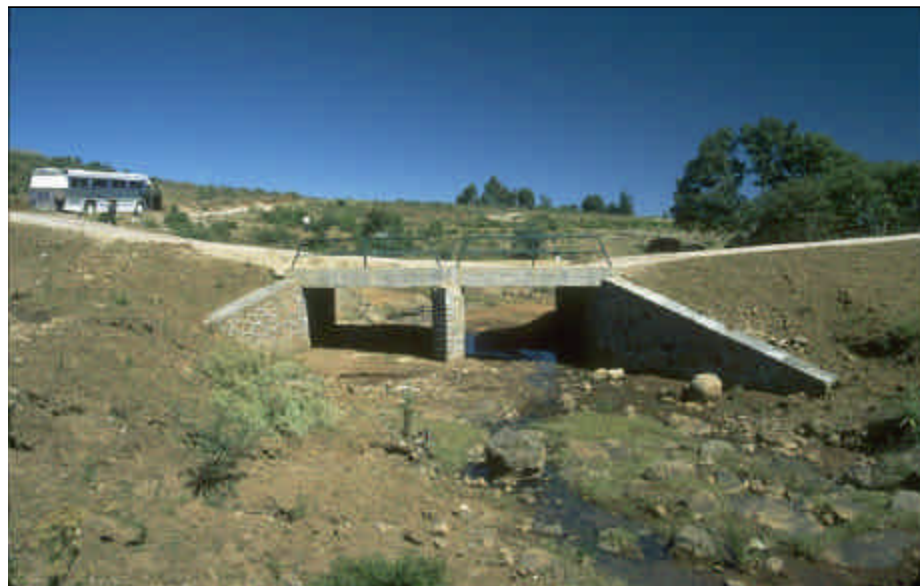
Foto 8.3 Instale alcantarillas de mampostería, de cajones de concreto o de metal, con un tamaño (capacidad) lo suficientemente grande para desalojar con seguridad la avenida de diseño anticipada (típicamente para un periodo de recurrencia de 20 a 50 años), con base en un análisis hidrológico. Use muros de cabeza o de alero siempre que sea posible.
