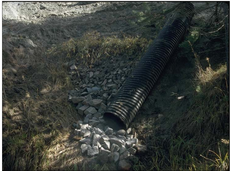
Foto 8.1 Proteja la salida de alcantarillas contra la corrosión. El enrocamiento bien graduado puede utilizarse para este propósito.
