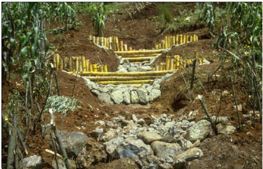
Foto 14.4 Construya las estructuras de retención de escombros (presa o diques) con un cimacio de herradura, para mantener el flujo por encima de la parte media de la estructura, coloque protección a la salida de cada estructura y ancle las estructuras en las márgenes de suelo firme.
