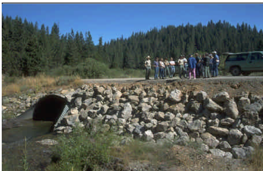
Foto 8.4 Alcantarilla tipo arco con placa estructural, con protección de las márgenes del arroyo a base de enrocamiento de gran tamaño, colocado sobre una capa de filtro de geotextil.
