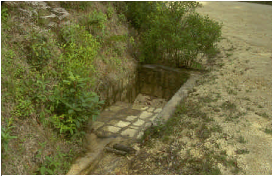
Foto 7.3 Use estructuras de toma hechas de mampostería, concreto o metal para controlar el agua en la cuneta y encauzarla hacia el tubo de drenaje transversal y evitar la socavación de la cuneta.
