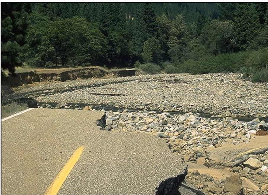
Foto 3.3 Un camino mal ubicado, en la peligrosa llanura de inundación de un río, que ha sido barrido durante una tormenta importante.
