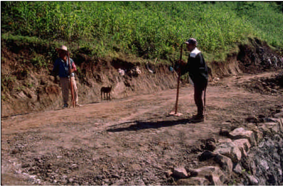
Foto 11.6 Compactación simple a mano, por detrás de un muro de roca. La compactación es importante en la parte posterior de cualquier estructura de contención o de un relleno.
