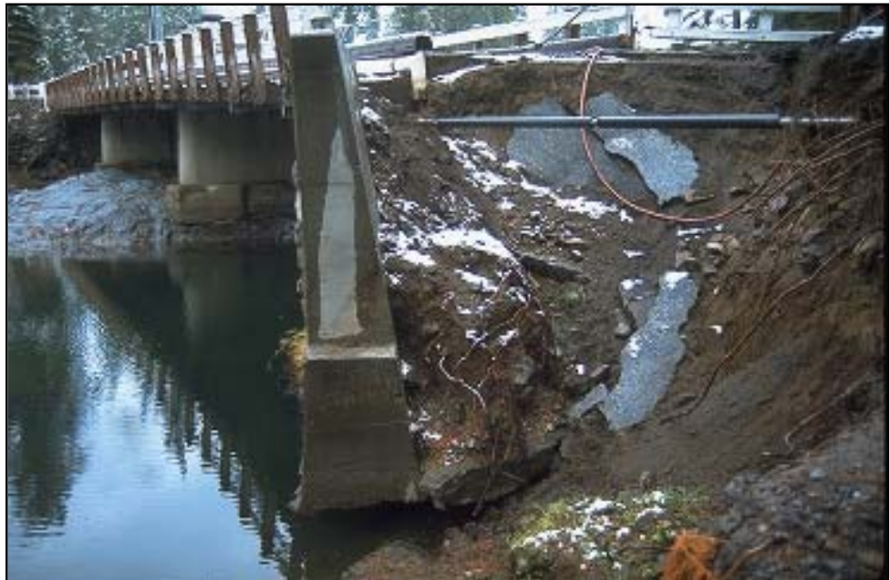
Foto 6.1 Socavación de un suelo fino detrás del estribo de un puente, causada por una protección insuficiente de las márgenes del arroyo durante una tormenta.
