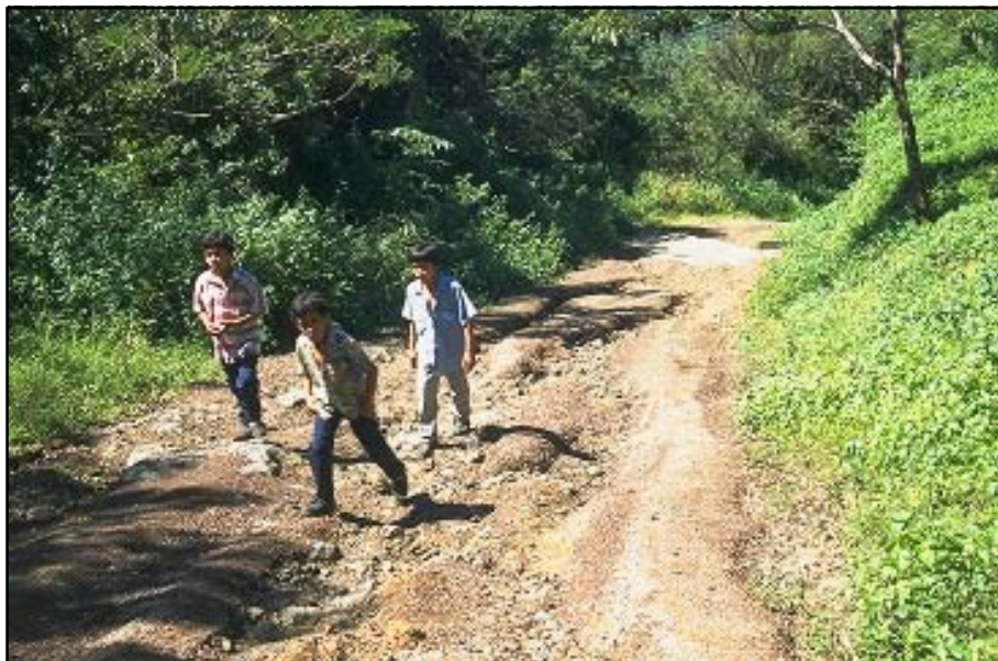
Foto 2.4 Impacto ambiental adverso producido por la erosión de la superficie del camino, derivada de pendientes abruptas y de drenes transversales. El mantenimiento de este camino también se vuelve difícil.
